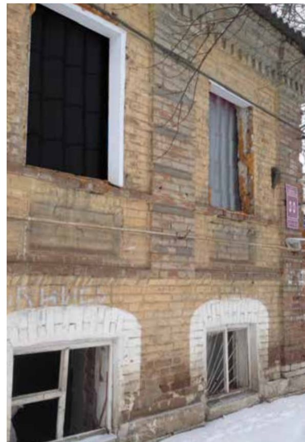
Стёкла окон в этом здании уже выбиты. А что дальше?
